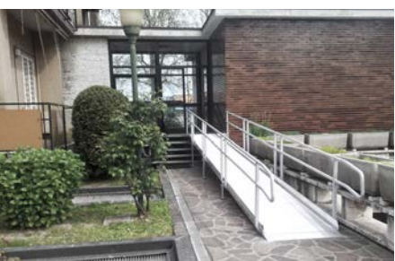
SUPERACIÓN BARRERAS ARQUITECTÓNICAS
